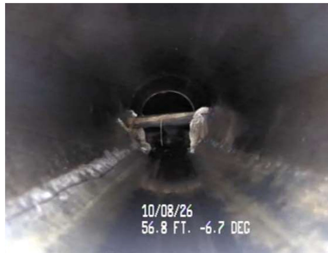
MH 104-141 之間的管道堵塞
