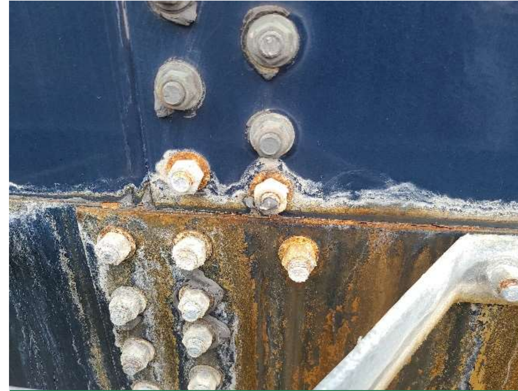
室外螺栓腐蝕和滲漏
