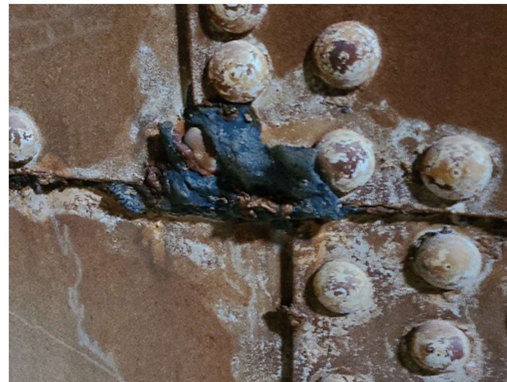
室內密封膠劣化
