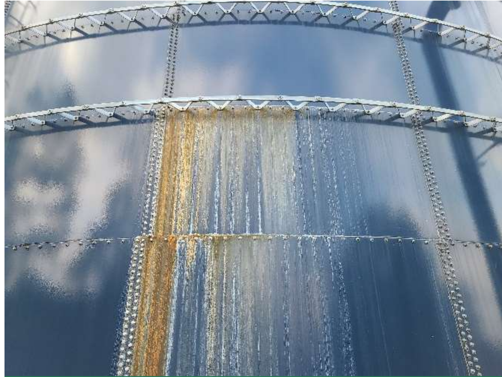
室外滲漏和劣化
