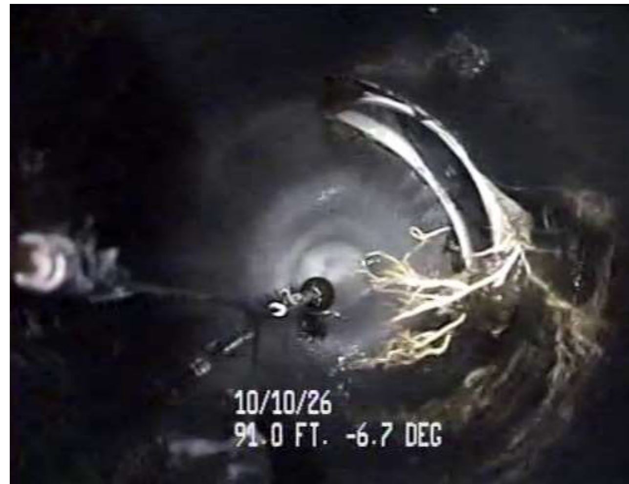
MH 90-92 之間的現有管道裂縫和樹根
