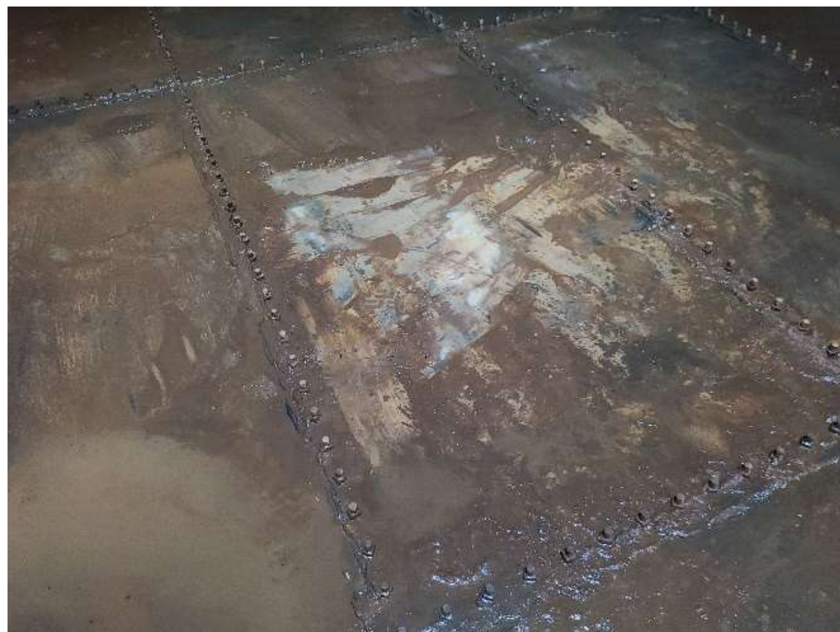
室內地板劣化
