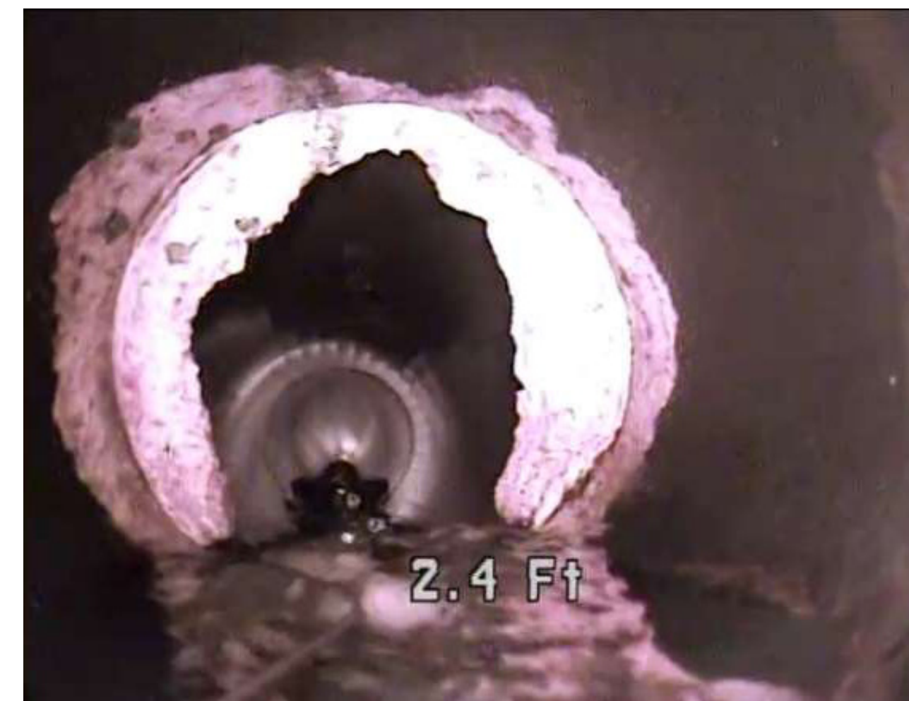
MH 119-120 之間的油脂
