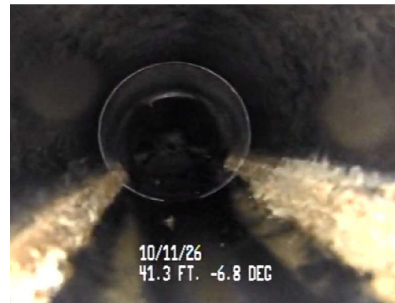
MH 119-120 之間的現有管道有油脂
