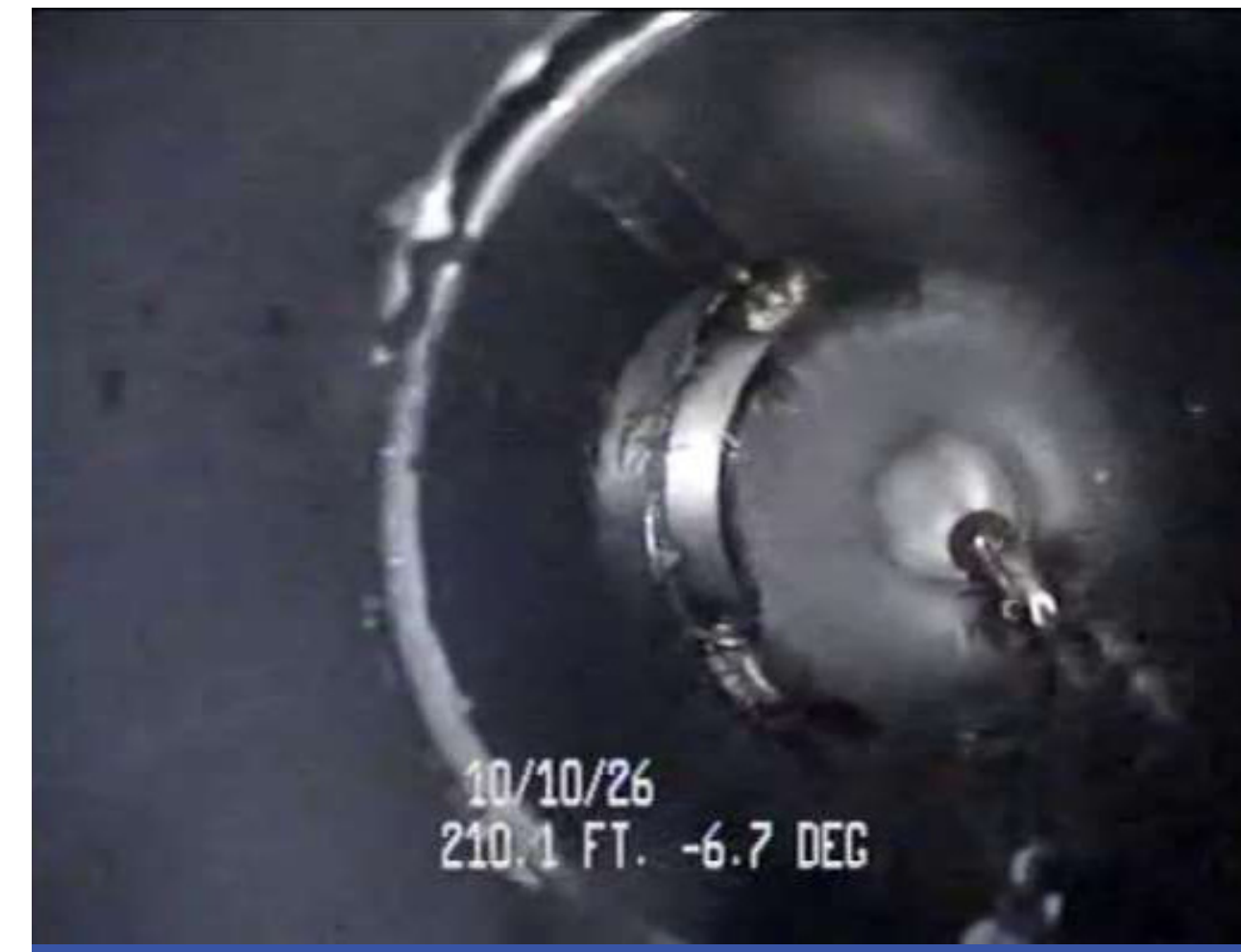
MH 90-92 之間的閘門破裂
