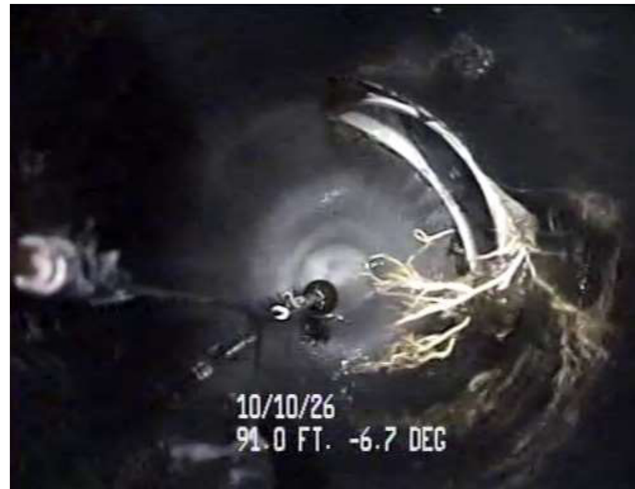
Vết Nứt ở Đường Ống Hiện Có và Chân Giữa MH 90-92
